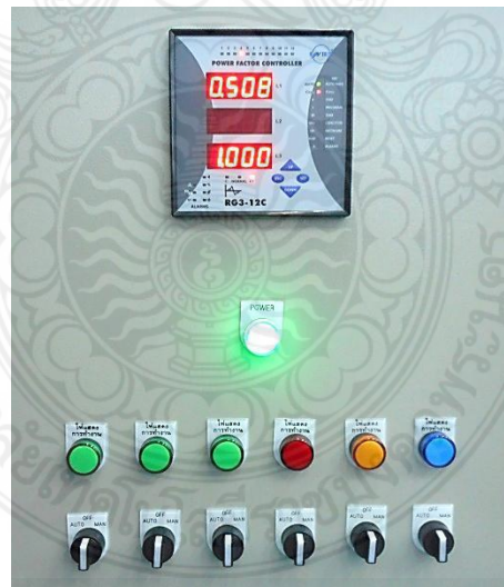
ภาพที่ 4-2 ค่า \cos\theta ก่อนการขนานคาปาซิเตอร์เข้าระบบ
