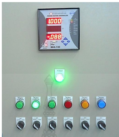
ภาพที่ 4-6 ค่า \cos\theta หลังการขนานคาปาซิเตอร์เข้าระบบ
