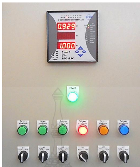
ภาพที่ 4-3 ค่า \cos\theta หลังการขนานคาปาซิเตอร์เข้าระบบ
