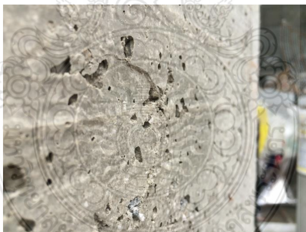
รูปที่ 4.11 ผนังคอนกรีตสำเร็จรูปผสมเศษโฟมจากบรรจุภัณฑ์เหลือทิ้งอัตราส่วน F75 ที่ถูกวัสดุแข็งขนาดเล็กกระแทกจนเกิดรอยยุบ
