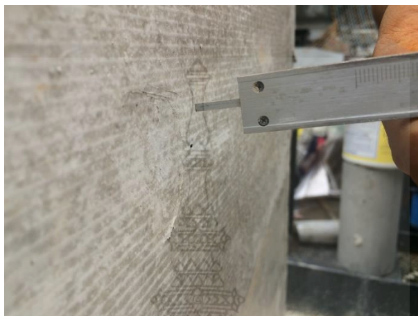
รูปที่ 4.10 ผนังคอนกรีตสำเร็จรูปผสมเศษโฟมจากบรรจุภัณฑ์เหลือทิ้งอัตราส่วน F50 ที่ถูกวัสดุแข็งขนาดเล็กกระแทกจนเกิดรอยยุบเพียงเล็กน้อย
