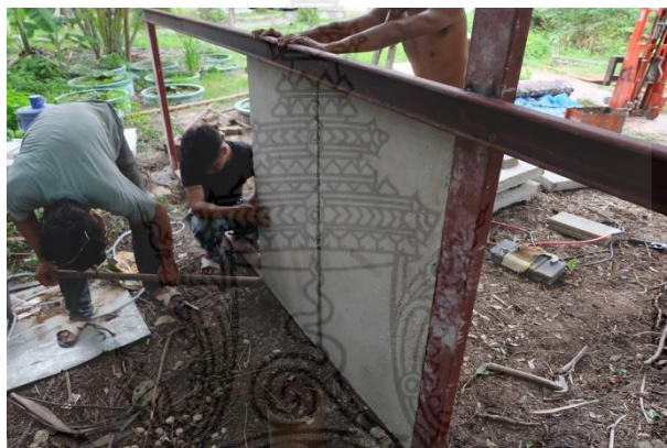
รูปที่ 4.23 การติดตั้งผนังคอนกรีตสำเร็จรูปผสมเศษโฟมจากบรรจุภัณฑ์เหลือทิ้งแผ่นต่อไป
