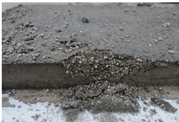
รูปที่ 4.6 ขอบที่หักบิ่นได้ง่ายของผนังคอนกรีตสำเร็จรูปผสมเศษโพลีเมอร์จากบรรจุภัณฑ์เหลือทิ้งอัตราส่วน F100 เมื่อผนังคอนกรีตดังกล่าวยังไม่เซ็ดตัวดี
