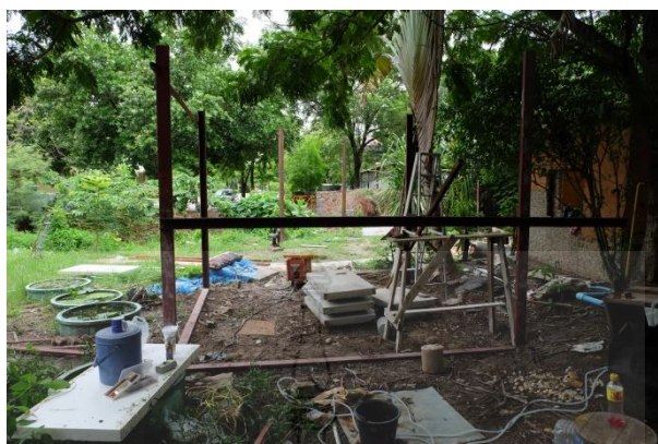
รูปที่ 4.19 การติดตั้งเสาเหล็กสำหรับทดสอบการใช้งานจริงของผนังคอนกรีตสำเร็จรูปผสมเศษโพงจากบรรจุภัณฑ์เหลือทิ้ง
