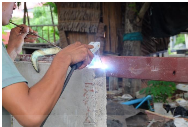
รูปที่ 4.25 การเชื่อมผนังคอนกรีตสำเร็จรูปผสมเศษโพงจากบรรจุภัณฑ์เหลือทิ้ง แผ่นต่อมาเข้ากับโครงชั่วคราว
