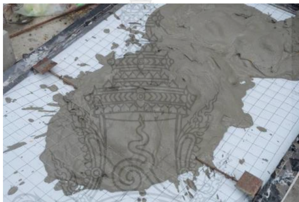
รูปที่ 3.21 การเทมอร์ตาร์ทรงในแบบหล่อผนังสำเร็จรูปด้านนอกส่วนกลางที่มีการติดตั้งเหล็กตะแกรงเหล็กแผ่น และเหล็กเส้นไว้แล้ว
