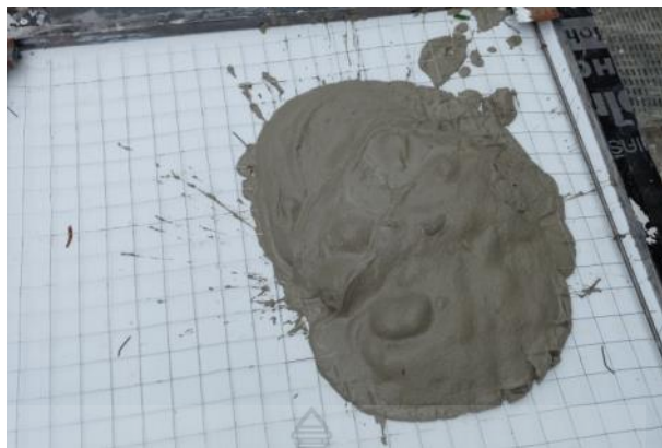
รูปที่ 3.20 การเทมอร์ตาร์ทรงในแบบหล่อผนังสำเร็จรูปด้านนอกส่วนบนที่มีการติดตั้งเหล็กตะแกรงเหล็กแผ่น และเหล็กเส้นไว้แล้ว
