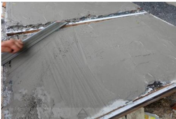
รูปที่ 3.23 การฉาบมอร์ตาร์ให้เรียบเพื่อใช้เป็นผนังสำเร็จรูปด้านนอกซึ่งภายในมีการติดตั้งเหล็กตะแกรงเหล็กแผ่น และเหล็กเส้น
