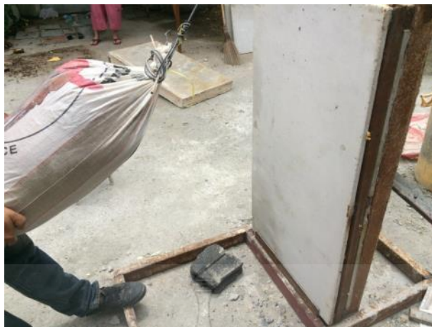
รูปที่ 3.56 การปล่อยวัสดุถมให้กระทงผนังคอนกรีตสำเร็จรูปตามที่มาตรฐานกำหนด
