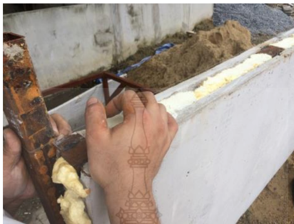
รูปที่ 3.49 การชั่งเอ็นสำหรับทดสอบความตรงของผนังคอนกรีตสำเร็จรูปมวลเบา
