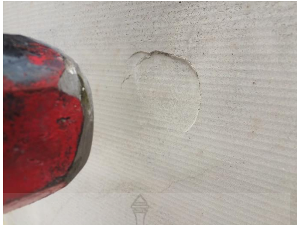
รูปที่ 15 ผนังคอนกรีตสำเร็จรูปที่ถูกรั่วสุดแข็งขนาดเล็กกระแทกจนเกิดรอยยุบ
