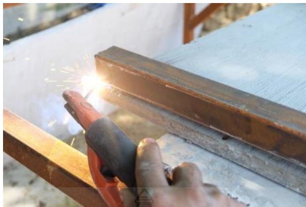
รูปที่ 3.29 การเชื่อมเหล็กกล่องบนแผ่นมอร์ตาร์สำหรับเป็นผนังสำเร็จรูป
