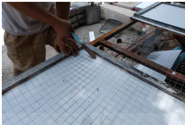
รูปที่ 3.17 การตัดและวางเหล็กตะแกรงลงในแบบหล่อพื้นผิวผนังสำเร็จรูปด้านนอก
