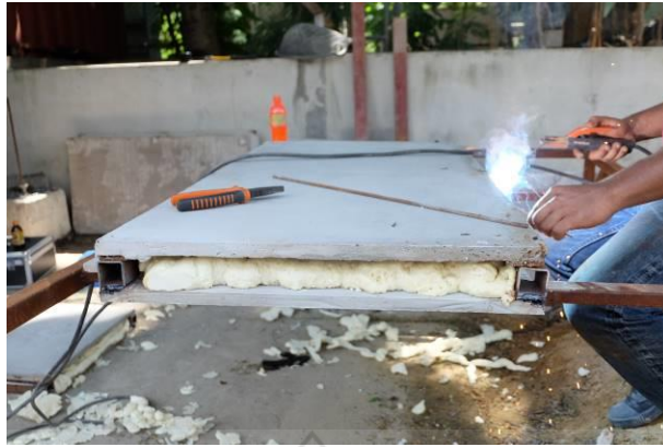
รูปที่ 7 การประกบและเชื่อมผนังสำเร็จรูปด้านบนอีกด้านล่างบนผนังที่มีการฉีดยาโฟมแล้ว
