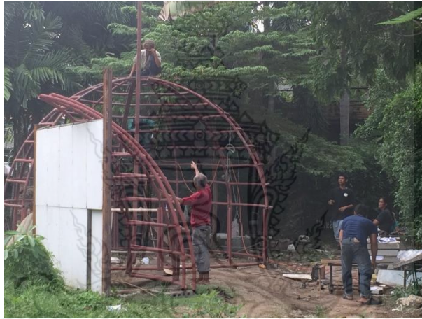
รูปที่ 15 โครงสร้างผนังส่วนบนและส่วนล่างที่เชื่อมติดกันแล้ว
