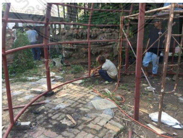
รูปที่ 4.21 การเชื่อมโครงสร้างผนังส่วนล่าง
