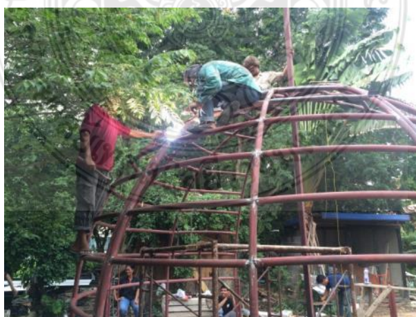
รูปที่ 4.33 การเชื่อมโครงสร้างผนังชั่วคราวเพื่อให้โครงสร้างเข้ารูปอย่างสมบูรณ์
