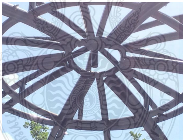
รูปที่ 18 โครงสร้างหลังคาที่ยึดเข้ากับโครงสร้างผนังอาคารส่วนบน
