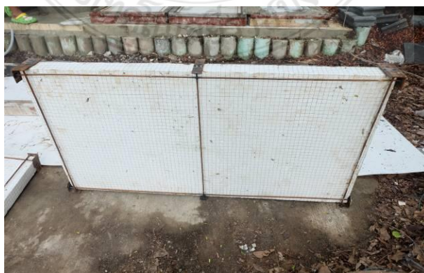
รูปที่ 3.21 การวางแนวเหล็กของผนังคอนกรีตสำเร็จรูปมวลเบาเสริมแผ่นโฟมอัดแน่นด้านนอน
