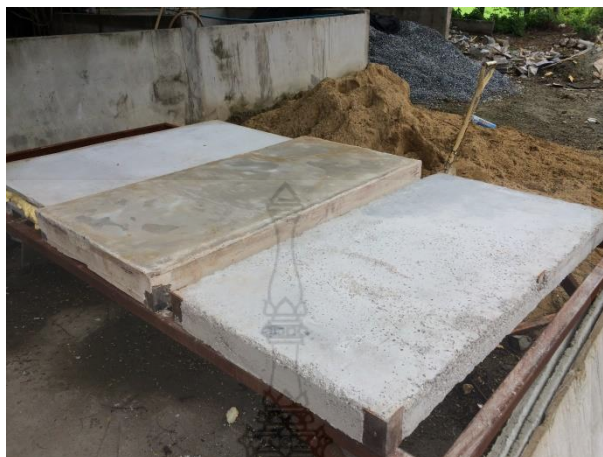
รูปที่ 3.45 การทดสอบความแข็งแรงของผนังคอนกรีตสำเร็จรูปมวลเบาเสริมแผ่นโฟมอัดแน่น
