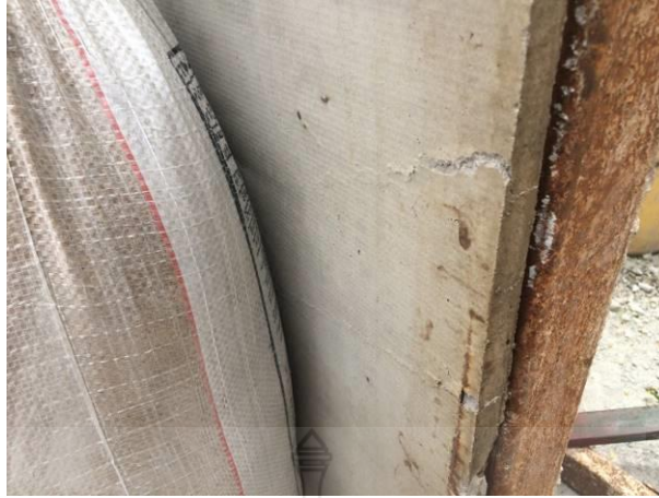
รูปที่ 13 ผนังคอนกรีตมวลเบาด้วยการเสริมแผ่นโพรหมัดแน่นที่ถุกัวส์ดุนุ่มขนาดใหญ่ กระแทกจนเกิดรอยร้าว
