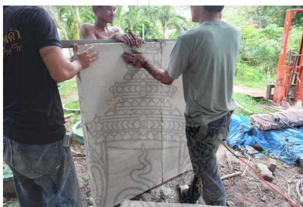
รูปที่ 4.23 การติดตั้งผนังคอนกรีตสำเร็จรูปมวลเบาเสริมแผ่นโฟมอัดแน่นแผ่นต่อไป
