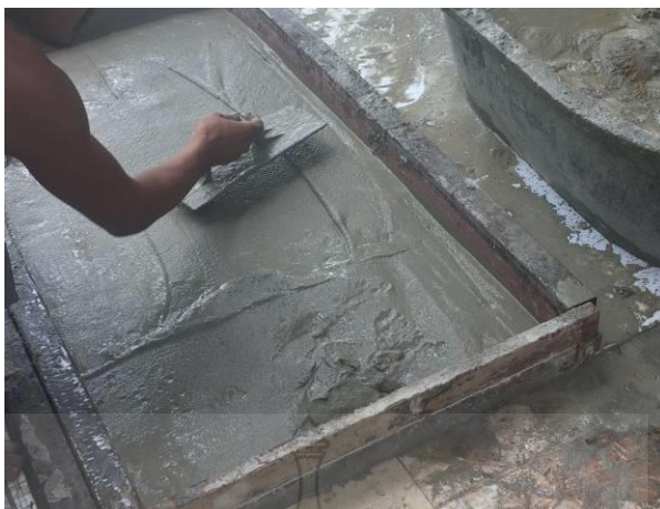
รูปที่ 3.25 การเทมอร์ตาร์เพื่อติดตั้งแผ่นโคมอัดแน่น
