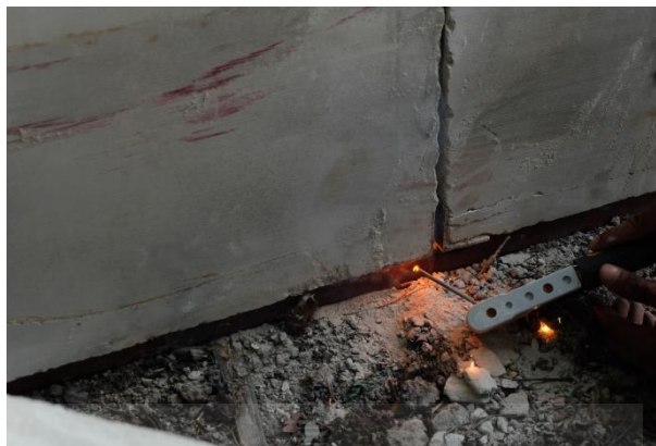
รูปที่ 4.25 การเชื่อมผนังคอนกรีตสำเร็จรูปมวลเบาเสริมแผ่นโฟมอัดแน่นให้เข้ากันสนิท
