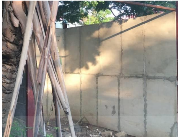
รูปที่ 20 ผนังคอนกรีตสำเร็จรูปมวลเบาเสริมแผ่นโฟมอัดแน่นภายหลังจากการฉาบร่อง
