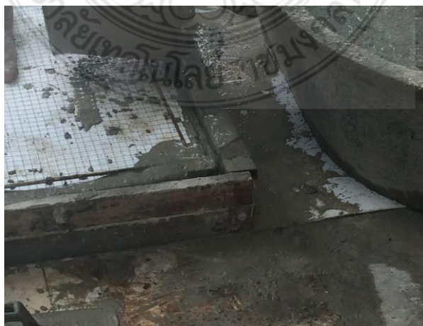
รูปที่ 3.30 การเทมอร์ต้ำรลงในมุมของแบบหล่อผนังคอนกรีตสำเร็จรูปมวลเบาเสริมแผ่นโฟมอัดแน่น
