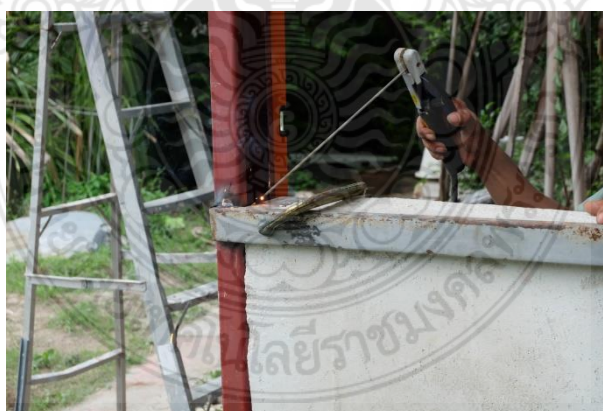
รูปที่ 4.21 การเชื่อมผนังคอนกรีตสำเร็จรูปมวลเบาเสริมแผ่นโฟมอัดแน่นชั่วคราว
