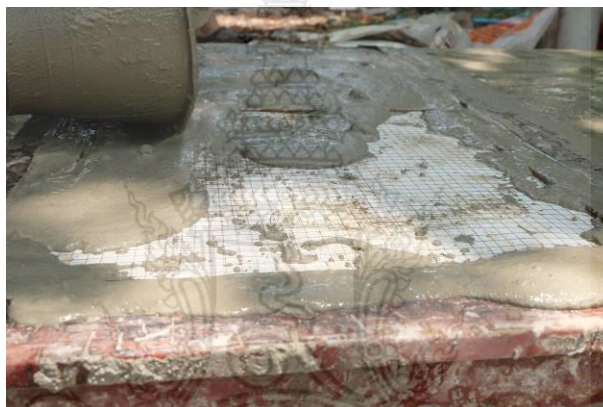
รูปที่ 3.32 การเทมอร์ตาร์ลงบนแผ่นผนังคอนกรีตสำเร็จรูปมวลเบาเสริมแผ่นโฟมอัดแน่น
