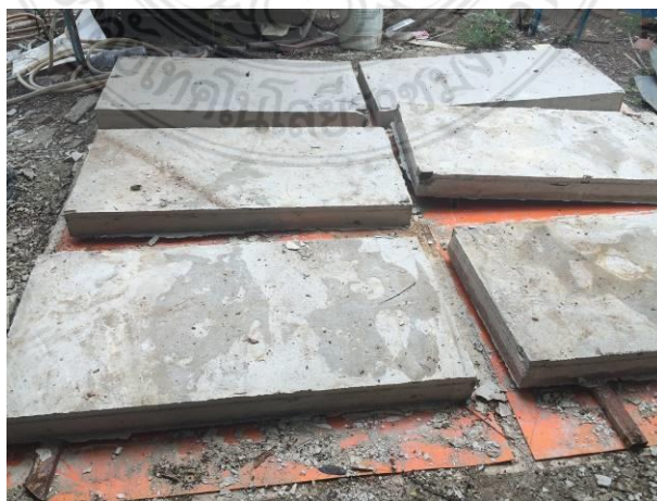
รูปที่ 3.36 การรอนผนังคอนกรีตสำเร็จรูปมวลเบาเสริมแผ่นโฟมอัดแน่นให้เซ็ดตัว
