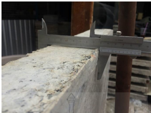
รูปที่ 4.3 การวัดขนาดของผนังคอนกรีตสำเร็จรูปมวลเบาเสริมแผ่นโพน้อัดแน่นด้วยเวอร์เนียคาลิเปอร์
