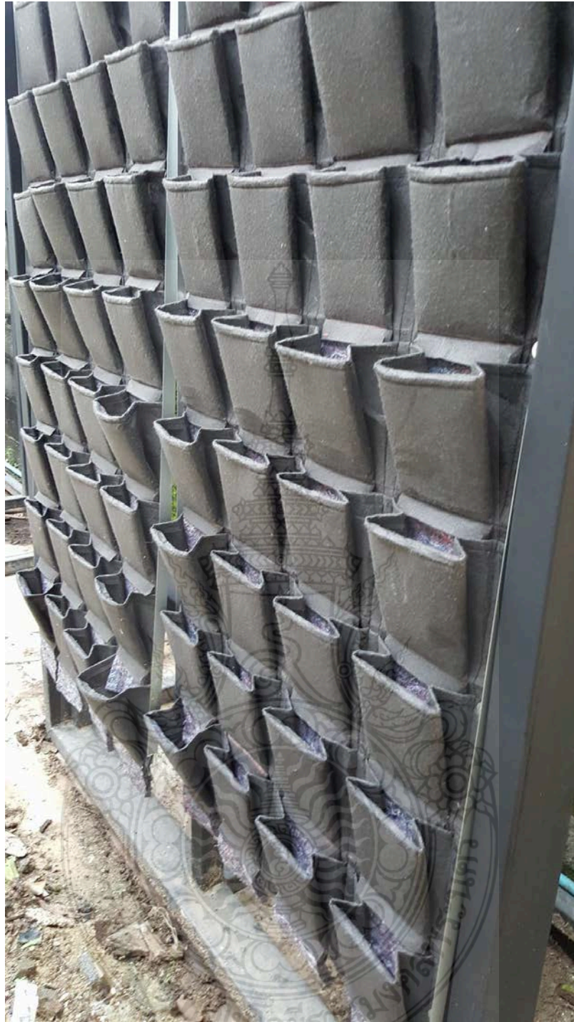
ภาพที่ 3.5 แสดงการติดตั้งแผ่นผนังปลูกพืชกับโครงผนัง
