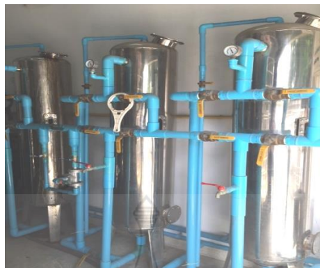
ภาพ 4.4 ถังกรองคาร์บอน
