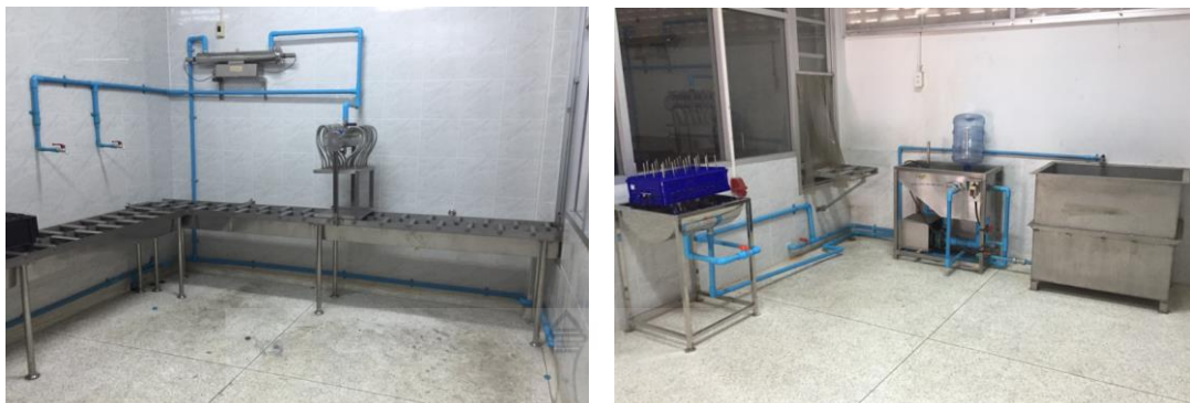
ภาพ 7.1 ระบบการบรรจุน้ำดื่มปัจจุบัน โดยใช้แรงงานจำนวน 4 คน
