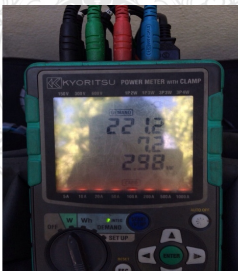
ภาพ 3.4 วัดค่าแรงดันไฟฟ้า กระแสไฟฟ้าและกำลังไฟฟ้าของเครื่องปรับอากาศก่อนการบำรุงรักษา
