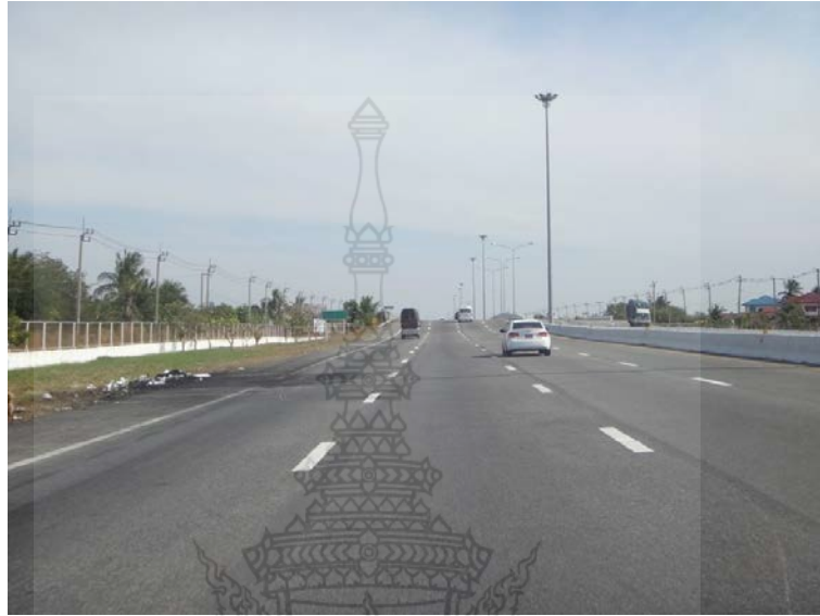
รูปที่ 4.3-5 ร่องรอยความเสียหายที่เกิดขึ้นจากอุบัติเหตุ
