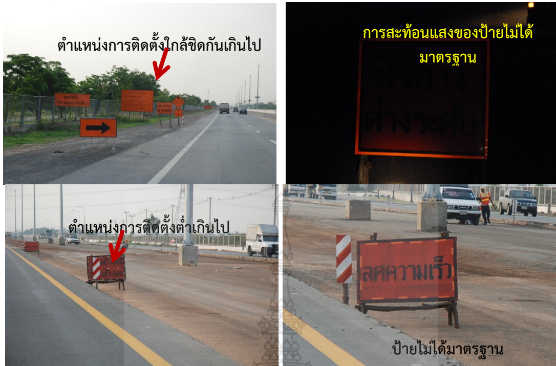
ภาพที่ 2.3-7 ตัวอย่างความบกพร่องการติดตั้งป้ายจราจร ป้ายเตือน ป้ายแนะนำ
