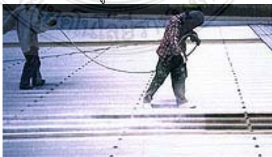
ภาพที่ 2.21 แสดงบริเวณผิวหลังคาขณะที่กำลังทาและพ่นเซรามิกโค้ทติ้ง
