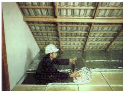
ภาพที่ 2.23 แสดงการติดตั้งฉนวนใยแก้วบริเวณเหนือฝ้าเพดาน ที่มา : www.spec2u.com/product
